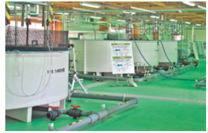
大小27基の水槽が並ぶ閉鎖循環式陸上養殖研究棟
