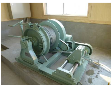
コンクリートブロックに固定されたウインチ
